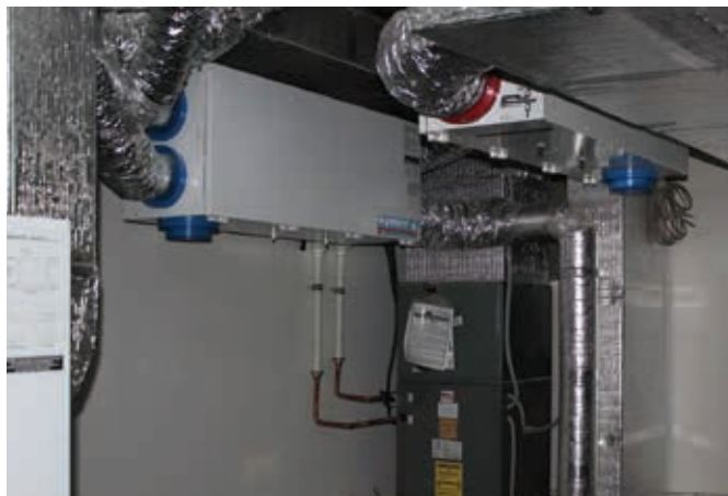
Рекуператор в системе воздушного отопления
