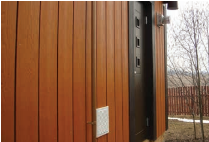
Подмес свежего воздуха с улицы через решётку
