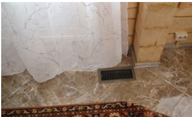
Подача воздуха в низконапорной системе через напольную решётку
