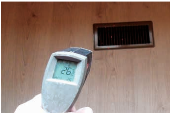
Температура выходящего воздуха из напольной решётки
