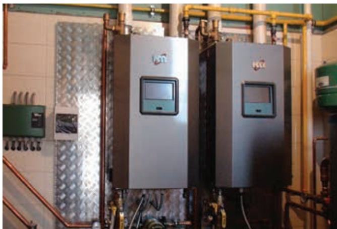
Газовые водогрейные котлы
