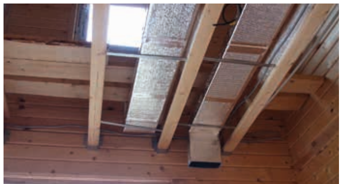
Воздуховоды в межэтажном перекрытии дома
